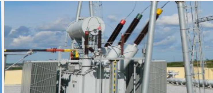
变电站运维管理
